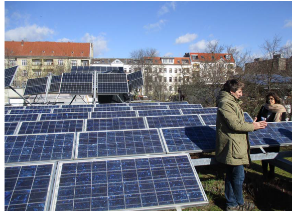
Sonnenkraft vom begrünten Dach ernten. Ein kleiner Schritt zum Klimaschutz in Berlin. UFA-Fabrik 2019
